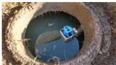
Emplacement du préfiltre
